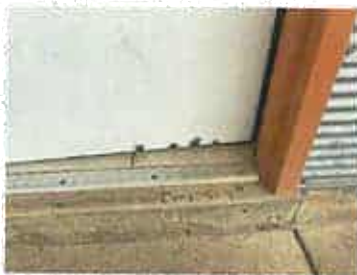
Damage bottom of kiosk door
